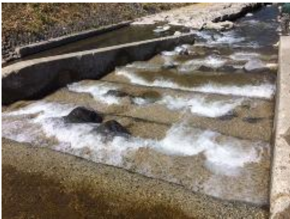
付け石が脱落した魚道 【牛道川(郡上市)】
