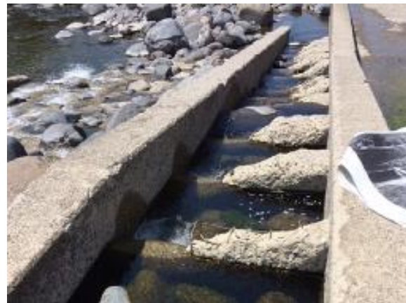
鉄筋が露出した魚道 【牛道川(郡上市)】
