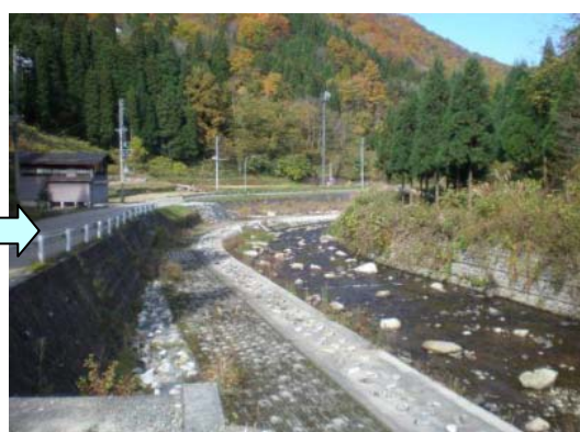
稲越川（飛騨市河合町稲越地内） H20.11 環境保全型ブロック護岸に植生が見られ、在来の植物回復が定着している。
