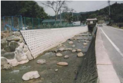
学校橋より30m程下流。河床に「捨石」を配置して川の流れが単調にならないようにした。生き物の生息空間を創出した。
