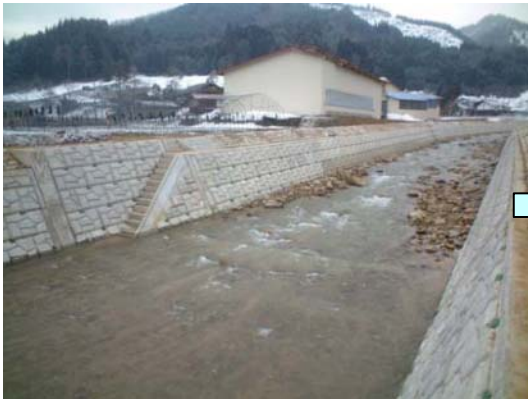
瓜巢川（高山市国府町金桶地内） 施工直後 捨石により、滞筋の多様化を促進している。
