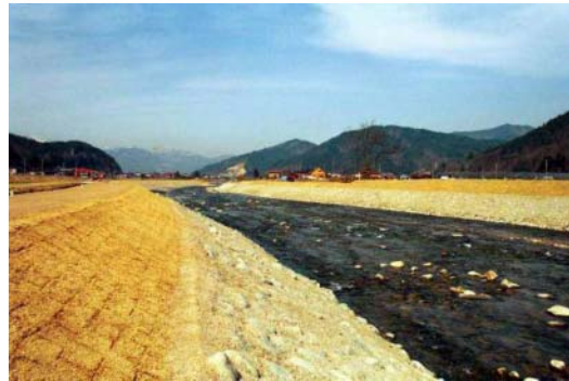
護岸工を緩勾配とし、河床に沈床や巨石を設け、瀬の創出を図った。
