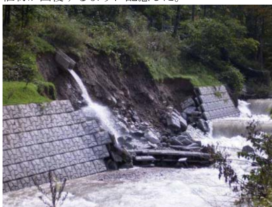
【失敗例】稲越川（飛騨市河合町稲越地内） 空積大型ブロックが基礎部の洗掘及び落差工下流の越流による背面土砂の流出により、機能しなくなった。
