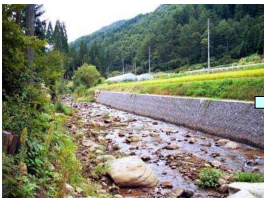
蔵柱川（高山市上宝町蔵柱地内） 施工直後 環境保全型ブロックの中でも採用事例の多いポーラス間知ブロックを用いた護岸により、出来るだけコンクリート面を隠すように配慮した。
