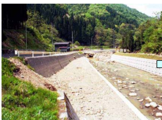
稲越川（飛騨市河合町稲越地内） 施工直後 植生の豊かな河岸 護岸は植生できるように、空隙のある環境保全型ブロックを使用し、中に現地発生土を入れました。これにより、これまでに稲越川にあった、在来の植物が回復するように配慮した。
