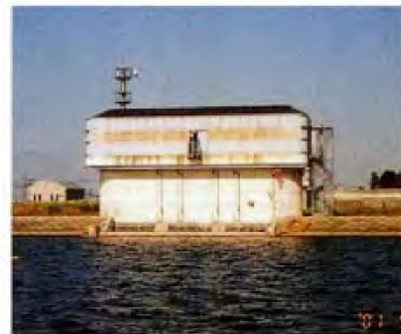
長良導水取水口(平成10年4月取水開始)
