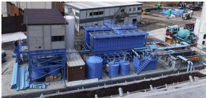
図 3-1-2(2) 濁水処理設備
