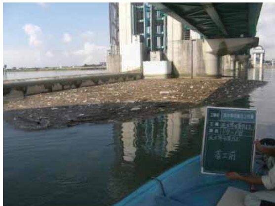
(堰上流部に滞留した流木・塵芥)
