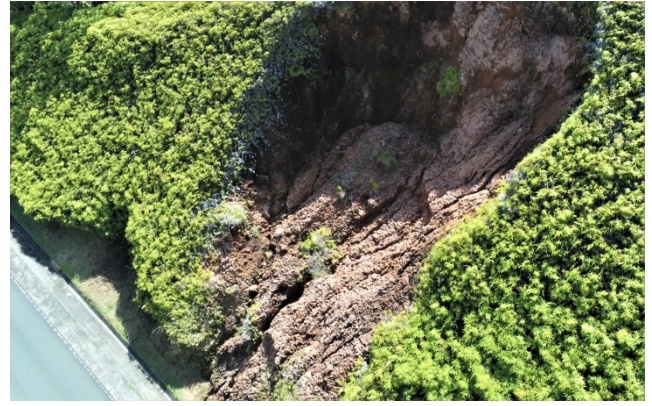
道路わきの斜面 崩落現場
