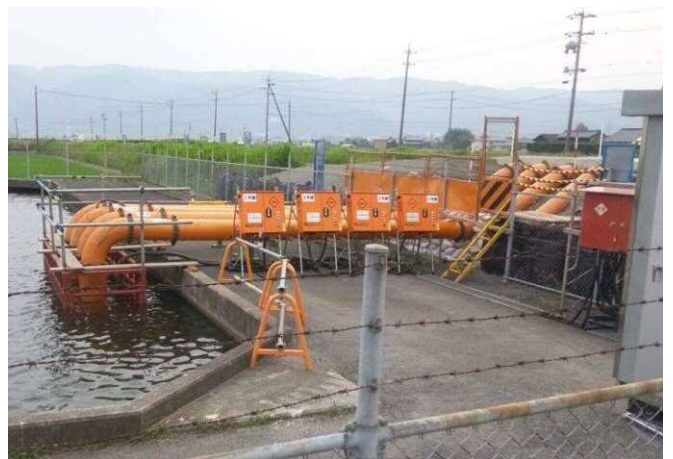
写真 2.2 専用ポンプ施設
