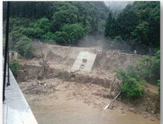
飛驒市宮川町牧戸地内 JR高山本線 土砂崩壊状況
