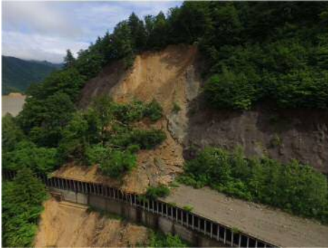
【モルタル吹付法面の崩壊（国道156号白川村内）】
