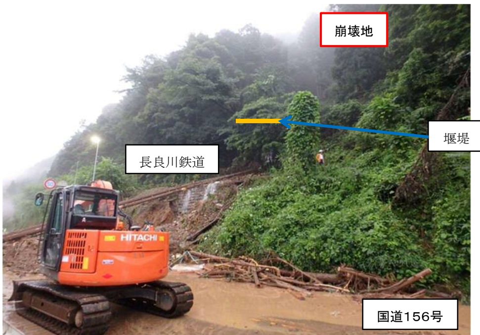
被災箇所②（美濃市曾代地内）
