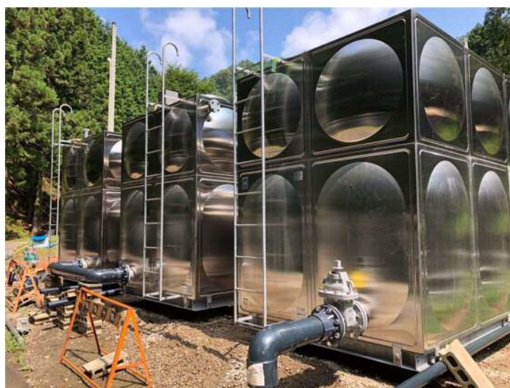
被災した配水池に代わる仮設配水池
