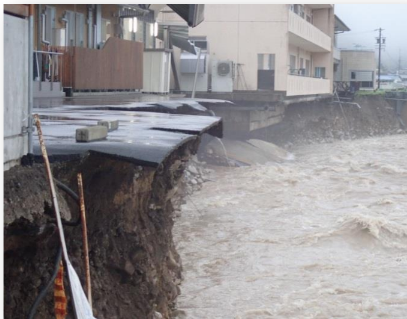
郡上市和良町方須地内 和良川 護岸決壊状況
