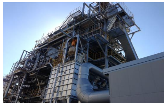
木質バイオマス発電施設（瑞穂市）
