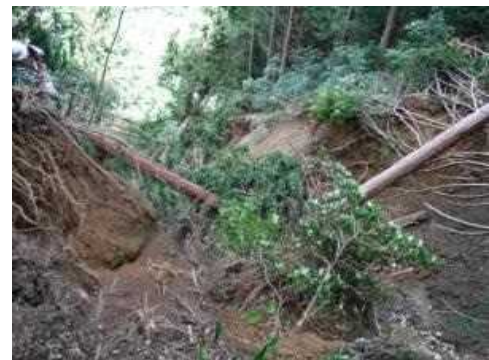
早急に対策が必要な箇所（山腹崩壊地）
