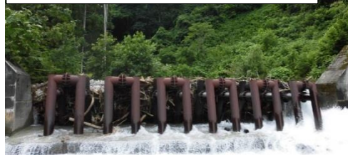
飛騨市宮川町森安谷地内の流木捕捉状況
