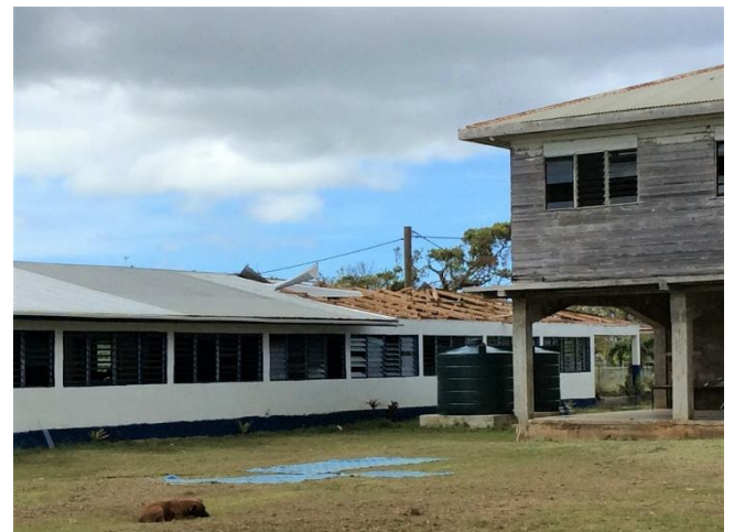
<屋根が半壊した小学校>
