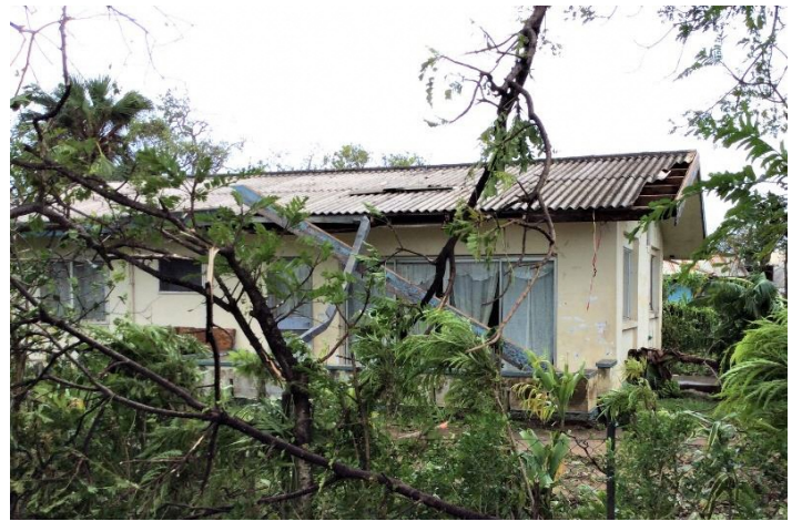
<半壊した隣家>
