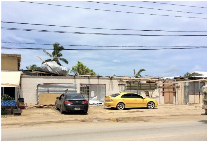
<屋根が吹き飛んだ家屋 ②>
