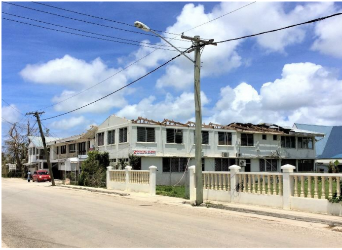
<屋根全体が吹き飛んだ建物と傾いた電柱>
