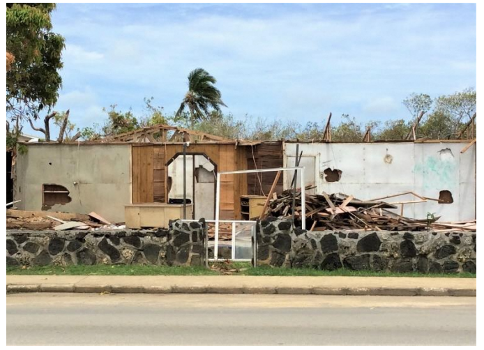
<屋根が吹き飛んだ家屋 ①>
