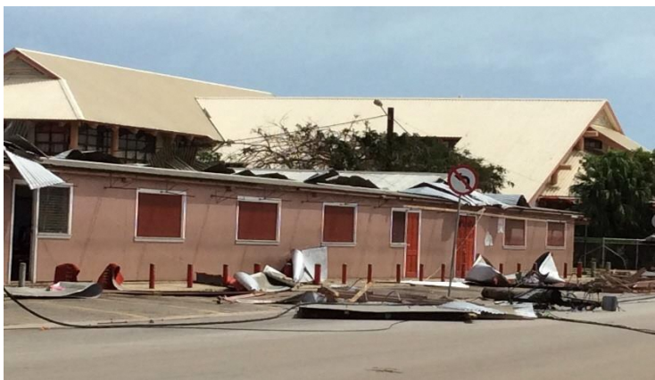
<屋根が損傷した商店と道路に横たわる電線>
