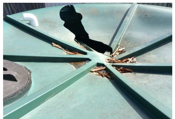
破損した雨水タンクのフタ
