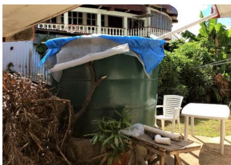
仮補修状態の雨水タンク、左側には一部マンゴーの枝が残ったまま。
