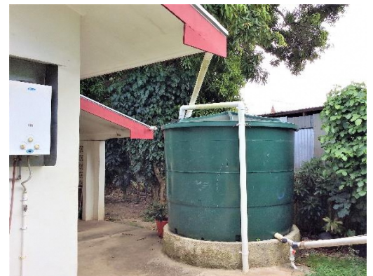
給湯器(左壁面)と被災前の雨水タンク
