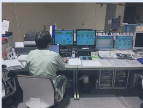
制御室における機器の監視
