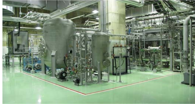
トリチウム除去装置(排気ガス処理システム)
