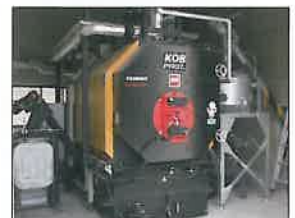
木質ペレットボイラー (下呂市)
