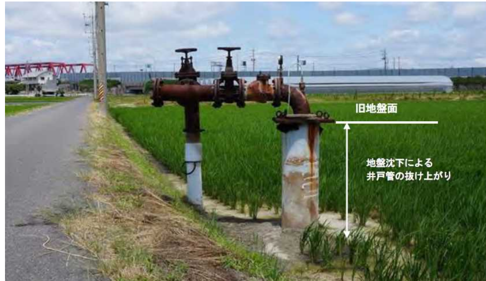
三重県桑名郡木曾岬町の井戸の抜け上がり状況 (平成26年6月撮影) 東海三県地盤沈下調査会より
