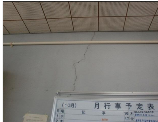
壁のひび割れ
