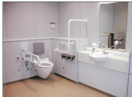
車いす対応 トイレ 【石川県】
