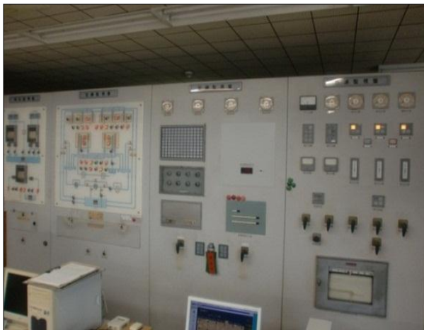
空調・熱源・衛生監視盤
