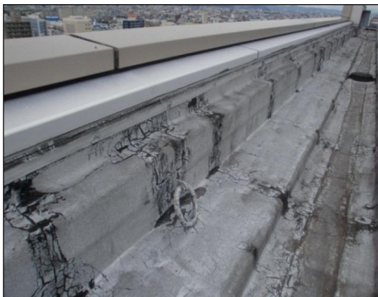
屋上防水の劣化
