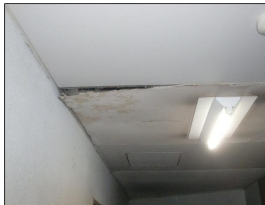
天井の仕上げ材の脱落
