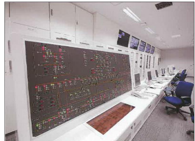
中央管理室【栃木県】
