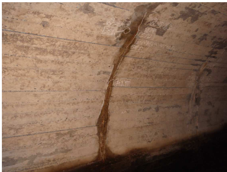
写真 2.2-8 継目部からの漏水（①滴水の事例）
