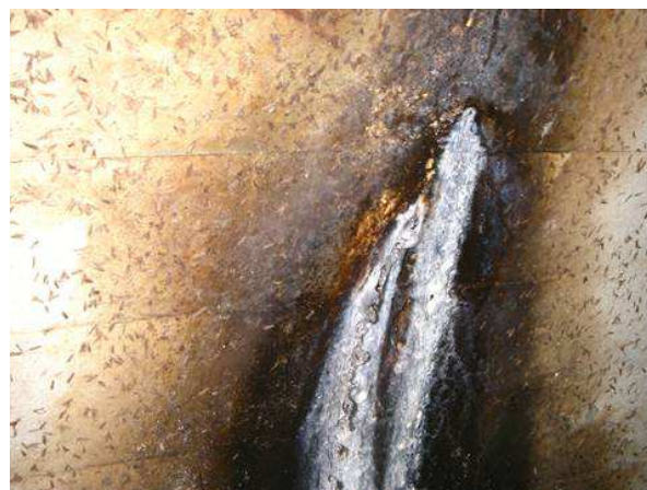
写真 2.2-6 ひび割れからの漏水（流水）
