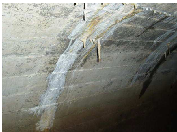
写真 2.2-4 ひび割れからの析出物
