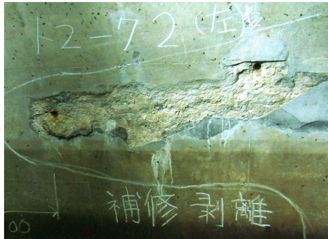
写真 2.2-7 剥離・剥落の監視状況（写真は部分的な剥離の状態）
