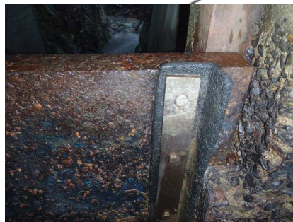
水密ゴムの損傷
