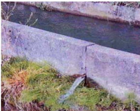
目地部からの漏水
