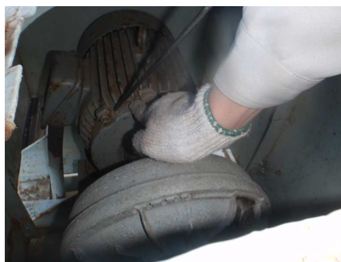
写真 2.4-2 除塵機（電動機）の振動・過熱確認
