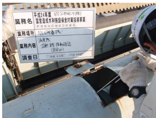
写真 2.4-1 除塵機（減速機）の異常音確認
