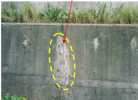
写真 2.2-3 ひび割れ部のエフロレッセンス
