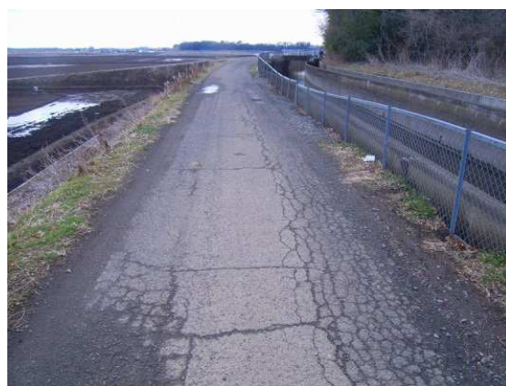
周辺地盤のひび割れ
