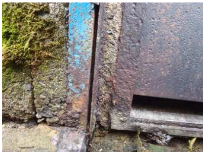
戸当りの腐食
