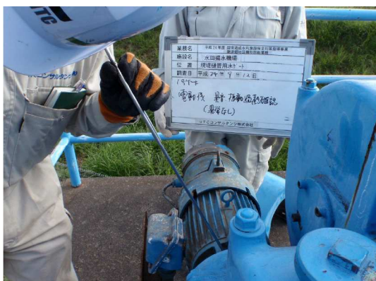
写真 2.3-1 開閉装置の異常音確認
