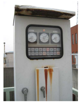
機側操作盤の腐食
