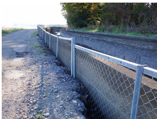
周辺地盤の陥没
