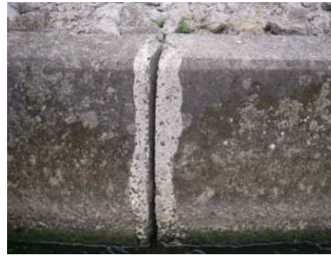
目地材の損傷（欠落）
