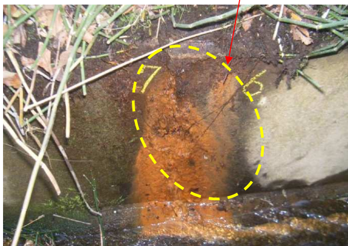
写真 2.2-5 ひび割れからの漏水（滲出しの例）
