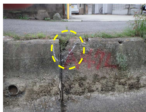
周縁コンクリートの欠損
