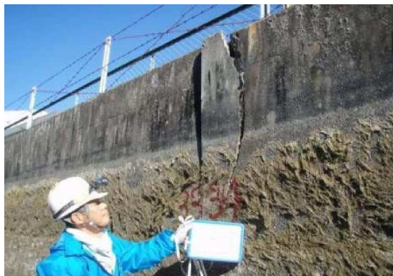
写真 2.2-7 剥離・剥落の監視状況（写真は部分的な剥離の状態）
