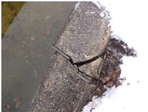
止水板の破断
