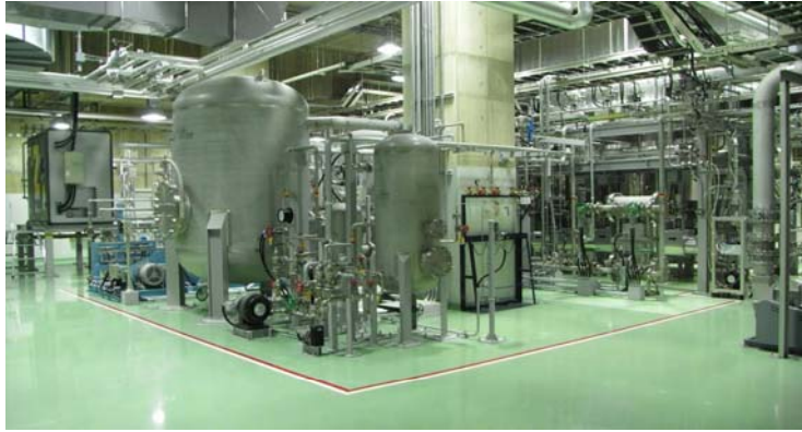
トリチウム除去装置(排気ガス処理システム)
