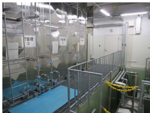
排水用貯留槽
