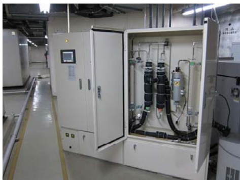
排気塔トリチウム捕集装置
