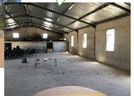
体育館は予算がなくて未完成。コンクリート打ちっ放しの状態・・・
