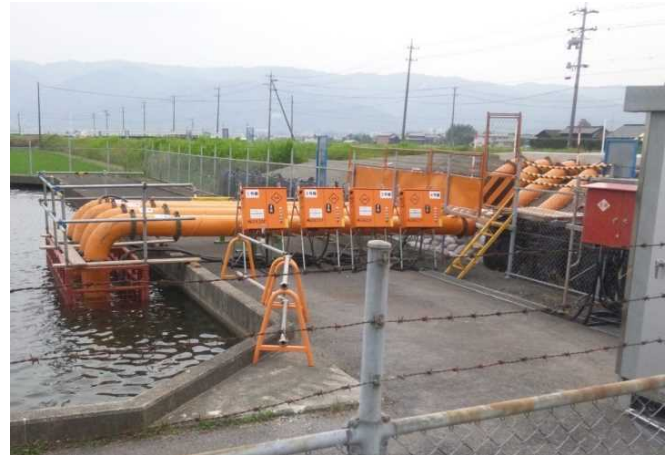
写真 2.2 専用ポンプ施設
